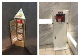
ELV内防災キャビネット、AED
