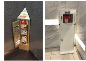
ELV内防災キャビネット、AED
