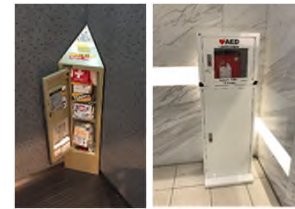
ELV内防災キャビネット、AED
